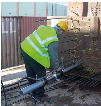
Fig. 10: tensor de 2 mangueiras 250 kN em operação
